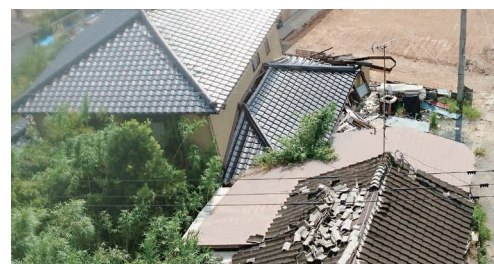
新耐震基準の住宅倒壊も発生した （熊本県益城町にて）
