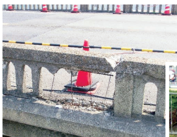
老朽化が著しかった幣塚橋
